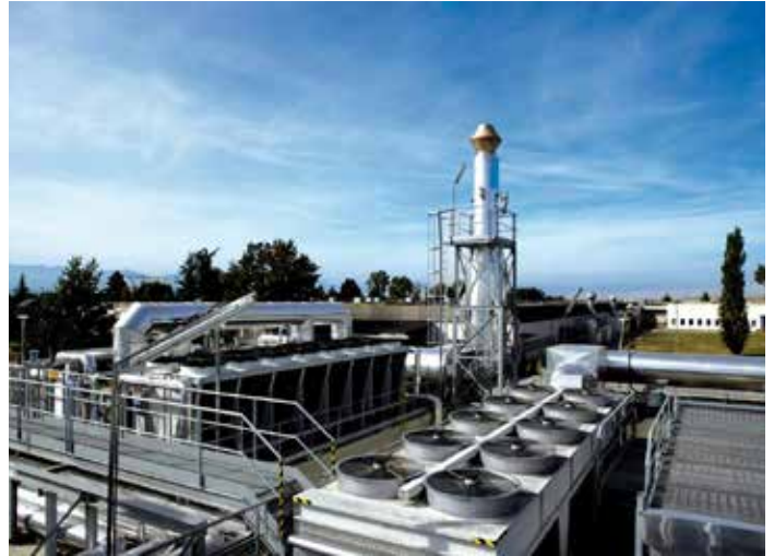
Impianti. Teleriscaldamento di Fossano e cogenerazione Michelin
